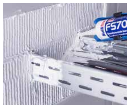
Detención contra incendios
