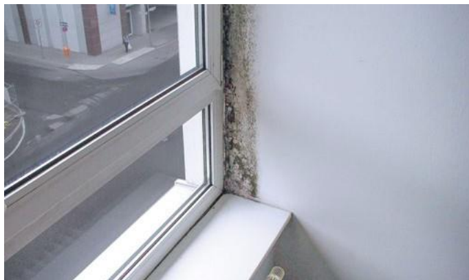
Widoczny przebieg izotermi 13°C. Smuga pleśni wskazuje, gdzie należało zamontować okno.
